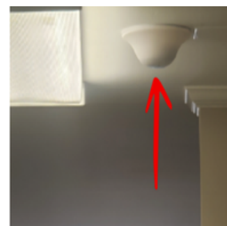
Indoor DAS server antenna
